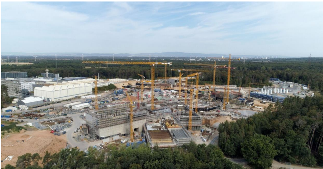
Perspectiva - septembrie 2022 - stadiul de construcției FAIR GSI, Darmstadt, Germania Sursă: Pagina de Facebook a FAIR GmbH – Facility for Antiproton and Ion research in Europe
