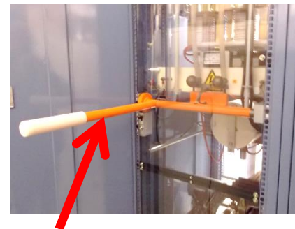
Erdungshebel auf der Rückseite des Netzgerätes
