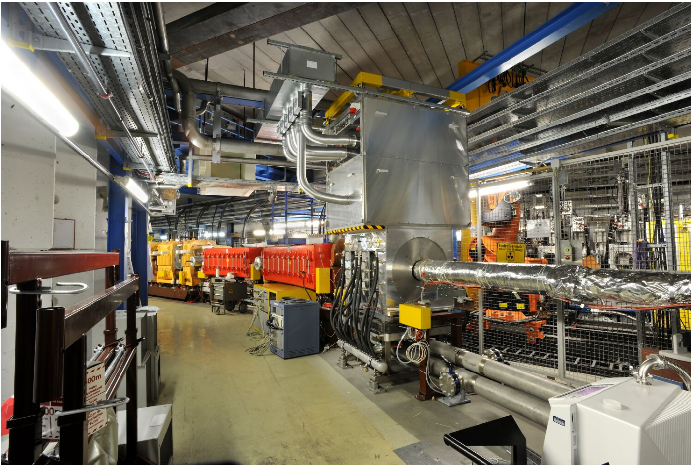
SIS18-Tunnel: h=2-Kavität mit darüber montiertem Tetrodenverstärker (Foto: G. Otto) (nur eine Einheit, inzwischen sind alle 3 Einheiten eingebaut)
